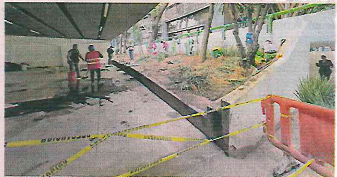
Trabajadores aún laboran algunos espacios. La zona permanece acordonada para impedir el paso de visitantes.
