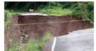
SOCAVÓN en la carretera México-Acapulco, en Chilpancingo, ayer.
