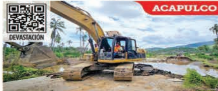
La carretera que comunica a Coyuca de Benítez con la Costa Grande, se encuentra dañada.
