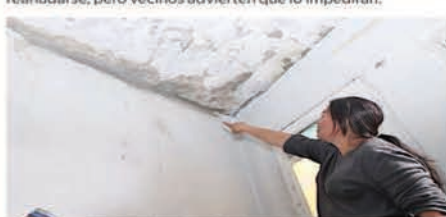
Elvía Mendoza, de Santiago Teyahualco, muestra los daños en su vivienda y reprocha que la obra colinde con su hogar.
