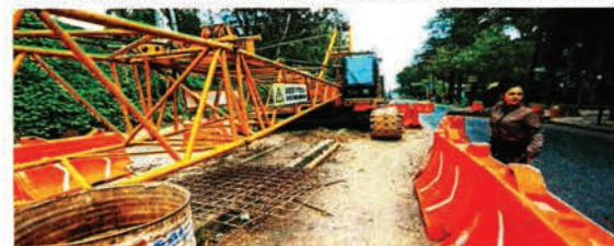
El título de concesión para la obra se otorgó desde hace 10 años, pero estaba detenida. Ahora Grupo ICA retomó la construcción.
