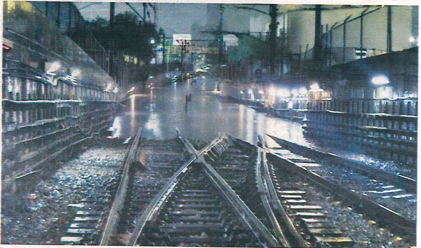
Personal de Instalaciones Hidráulicas y Mecánicas del Metro trabajó para drenar el agua que ingresó del exterior.
