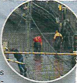
Extraen 3 millones 800 mil litros de agua del cajón de vías.
