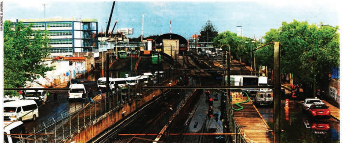
El agua de lluvia se estancó en el cajón de vías del tramo La Paz-Los Reyes, en la Línea A del Metro, por lo que personal del Sistema de Transporte Colectivo trabajó en el retiro del lodo y limpieza de la estructura para reanudar el servicio.
