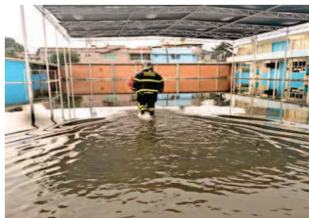
Fotos: Tomadas de X El patio de una escuela primaria, ubicada en Tlahuac, se inundó debido a la fuerte lluvia que se vivió en esa zona.
