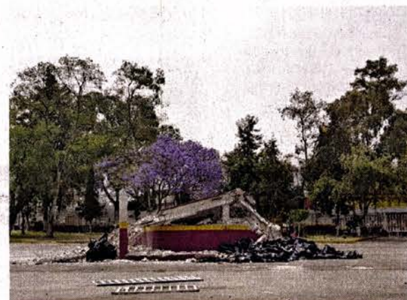
Un quiosco fue demolido por autoridades el lunes, ayer el cascajo aún yacía en el lugar.
