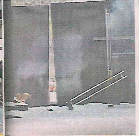
Los petardos dañaron vidrios y un acceso a la Cámara alta.
