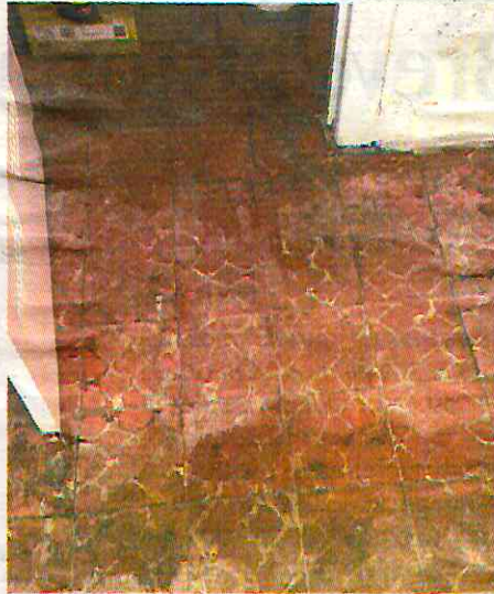
Piso dañado de los afectados.
