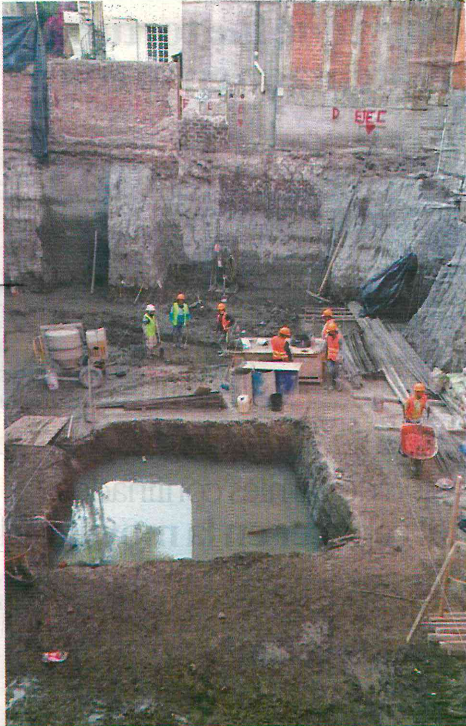
Cuando inició la construcción se rompió el manto freático, lo que provocó que saliera la humedad y permaneciera durante años.
