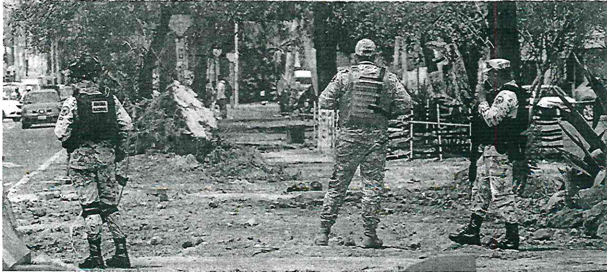
A LA VISTA DE TODOS. La primera fuga detectada en el camellón de Avenida 604, en la Colonia Narciso Bassols.
