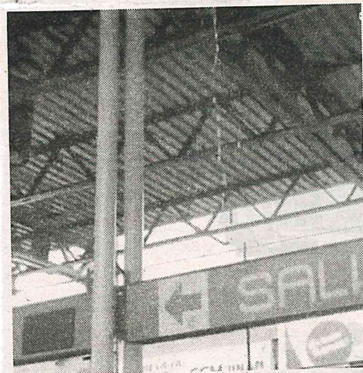
No cuenta con el mantenimiento necesario
