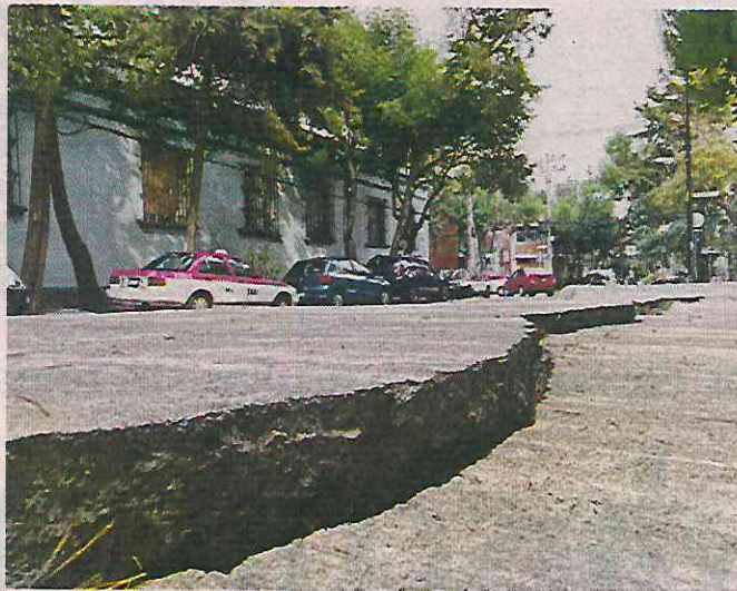
La actividad más reciente de la falla provocó daños en viviendas y vialidades.
