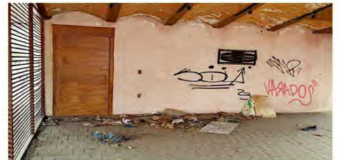
■ Un foro metálico quedó sin uso.
