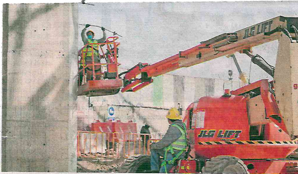
Sobre los carriles laterales de la autopista es donde hay mayor presencia de trabajadores y de maquinaria que participan en el proyecto.
