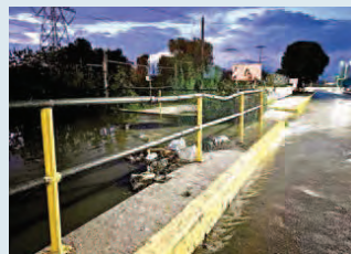
La anegación se dio en las inmediaciones del Ciclo Combinado de la Termoelectrónica y el acceso a instalaciones de Pemex.
