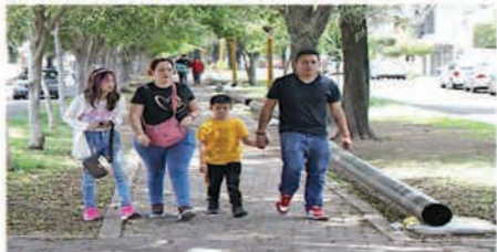
Los ductos en el lugar son para colocar una red emergente, pues la definitiva estará a 20 metros de profundidad.
