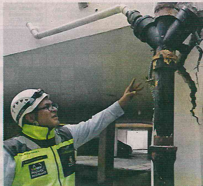
■ El Gobierno de CDMX consideró que el inmueble podía ser rehabilitado, pero vecinos se movilizaron y lograron que se le catalogara como de alto riesgo.
