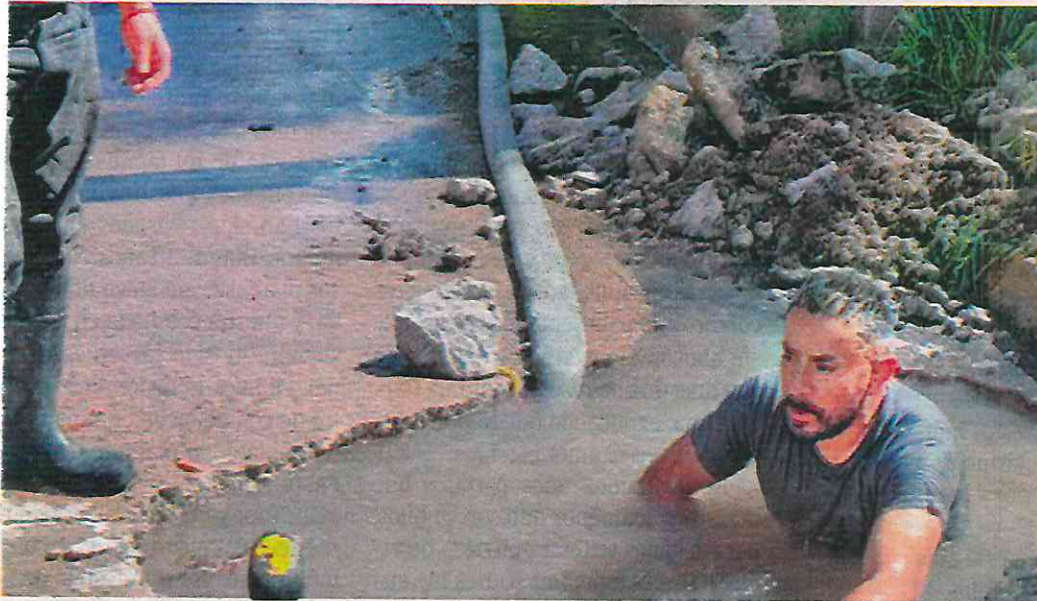
Se tiene previsto que sea aproximadamente en 20 años para el cambio de toda la red hidráulica en la Ciudad de México, además de que ya no existan fugas /CORTESÍA: OAPAS NAUCALPAN
