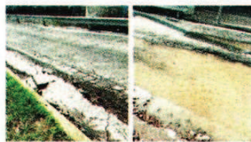
El concreto presenta graves fracturas
