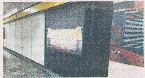
El espacio ha sufrido fuertes daños por lluvias
