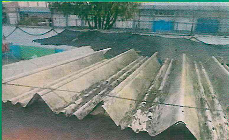
Varios espacios presentan deterioro. Uno de los más notorios es el techo, con tierra acumulada y desprendimiento de acabados.
