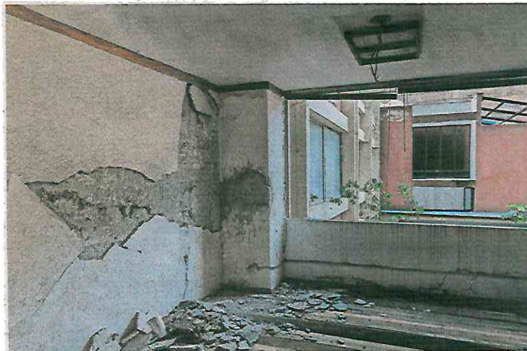
El inmueble que se dañó en el 19-S resiente el paso del tiempo y cada día está más deteriorado y representa mayor riesgo.
