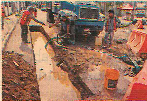
Una de las metas del gobierno es la rehabilitación del sistema de distribución de agua potable de la capital del país. FOTO: CUARTOSCURO
