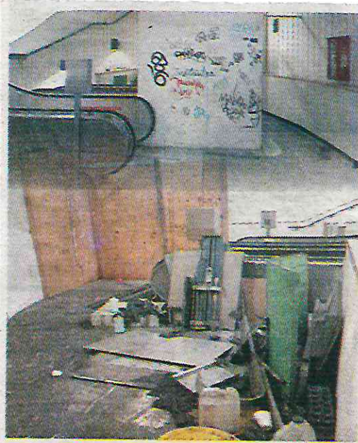
Escaleras no funcionan desde hace 2 años
