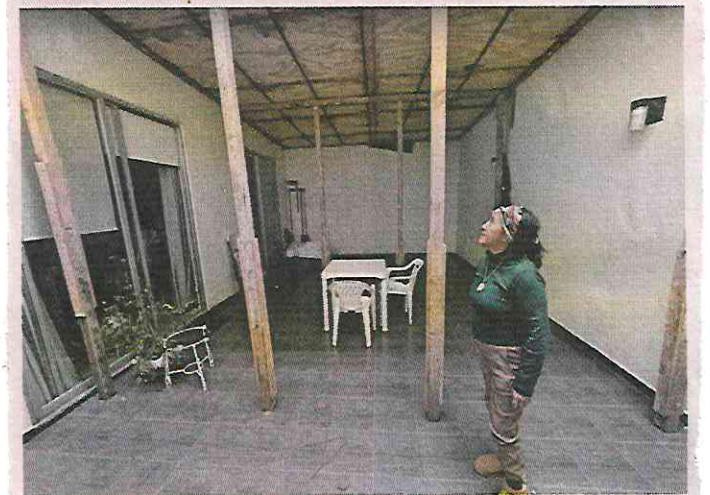
■ María Inés Cervantes, vecina de Granadas, muestra el interior de su casa, dañada por la construcción de una torre.
