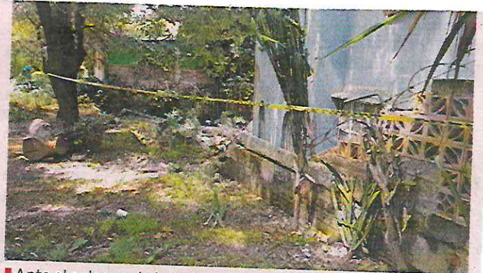
■ Ante el colapso de la barda, una cinta impide el paso al jardín.
