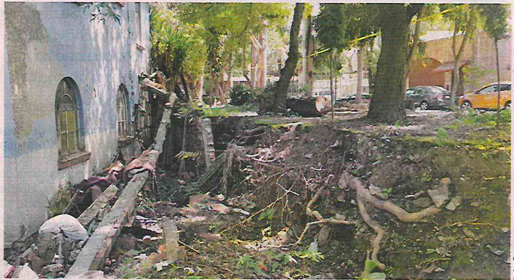
■ Dentro de la vivienda sigue derrumbada la barda que fue arrastrada por la corriente.
