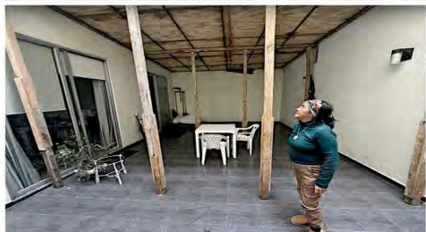
María Inés Cervantes, vecina de Granadas, muestra el interior de su casa, dañada por la construcción de una torre.
