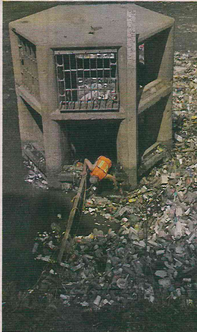
LIMPIEZA. Personal de la Comisión Nacional del Agua realiza trabajos para despejar el drenaje tapado por basura.
