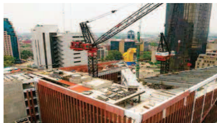
Aspectos de la construcción del AGA, obra que recientemente fue visitada por la jefa de Gobierno electa, Clara Brugada.
