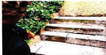
Los estruendos registrados desde el 18 de julio han causado grietas en algunas viviendas.
