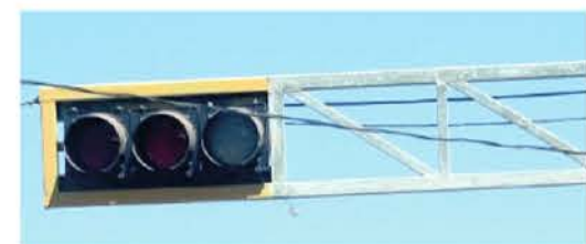
Hay colapsos vehiculares por este problema
