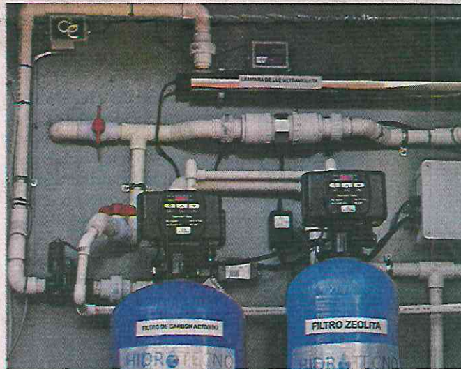
El proceso de tratamiento incluye la circulación del caudal a través de estos dos filtros para mejorar la calidad.
