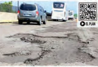
Las obras del Tren Maya dejaron casi mil kilómetros de carreteras dañadas, según datos de la SICT.
