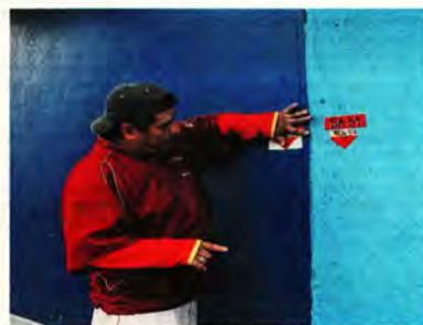
En Minas de Cristo, los DRO pusieron flechas rojas para observar el nivel de hundimiento de las casas.
