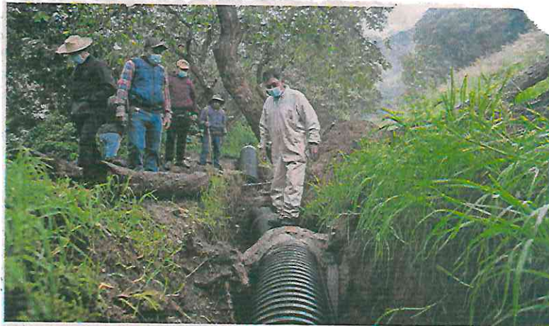
Afectados aseguran que Sacmex les dijo que ya había reparado la tubería, pero en la zona permanece el flujo de aguas residuales y obras sin conexión.
