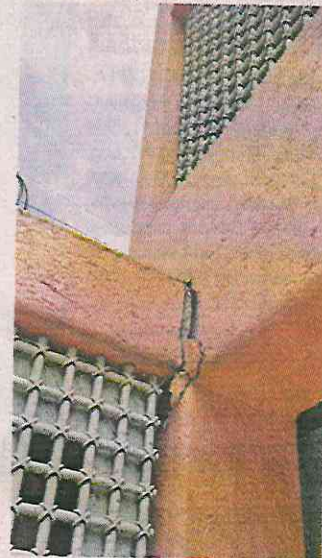
■ Las grietas ya alcanzaron a algunas casas.
