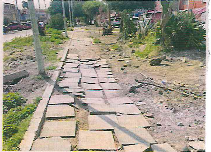
El camellón en el que fue retirada la tubería luce descuidada, pues únicamente fue cubierto con tierra.
