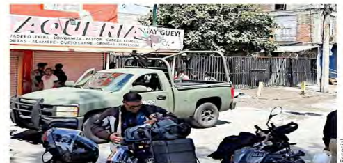
En el lugar se removió tierra y concreto para tratar de identificar una toma clandestina.
