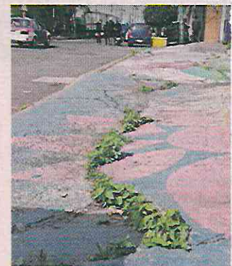
La zona fue afectada por un socavón desde 2007.
