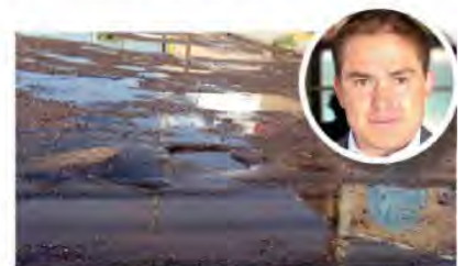
Las calles en la zona están repletas de baches
