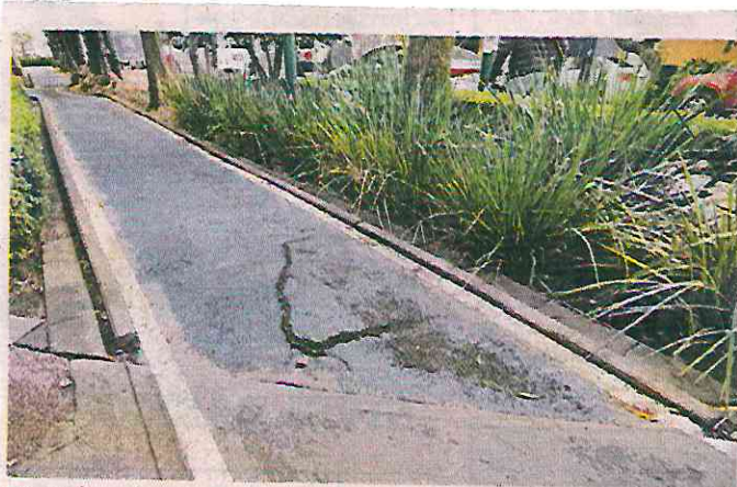
La infraestructura de parques en la demarcación presentan daños y desgaste que no han sido atendidos.
