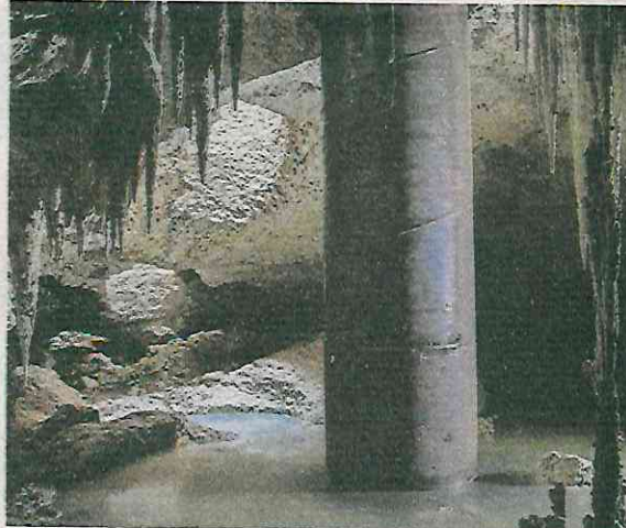
En el Tramo 5, de Cancún a Tulum, se hincaron más de 15 mil pilotes que dañaron a 120 cavernas y cenotes.
