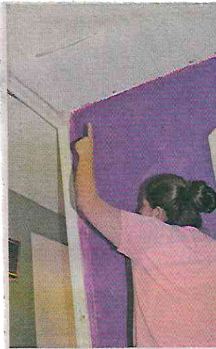
■ Habitantes del edificio temen por los daños y los sismos.
