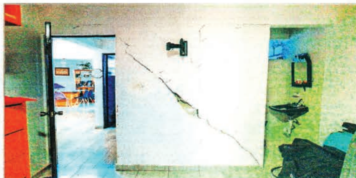
EL UNIVERSAL ha documentado cómo los movimientos derivados de la falla Plateros-Mixcoac han afectado a las viviendas de la zona, donde ya se han registrado grietas.
