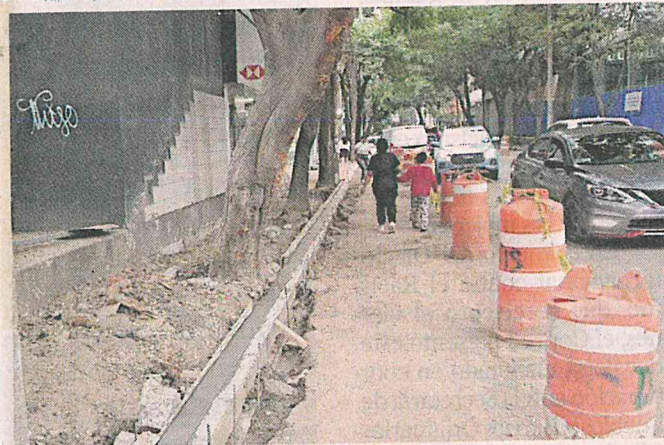
■ Las obras debieron concluir en febrero, sin embargo, apenas tienen un avance del 30 por ciento.
