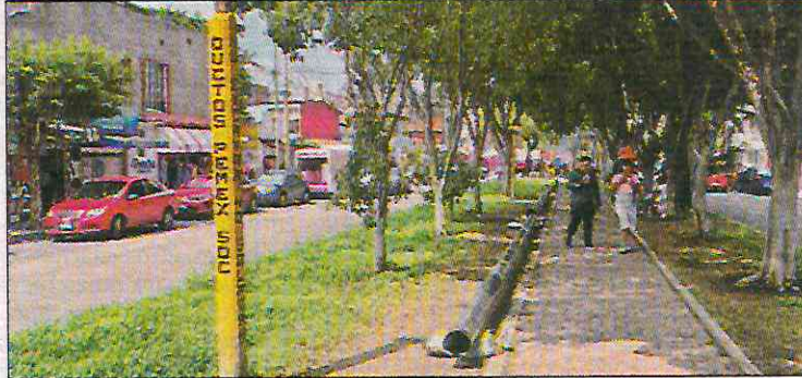
▲ Habrá sustitución de tubos en colonias de la Gustavo A. Madero y en Nezahualcóyotl tras los daños causados por las tomas clandestinas de turbosina. Foto Pablo Ramos ELBA MÓNICA BRAVO / P 34
