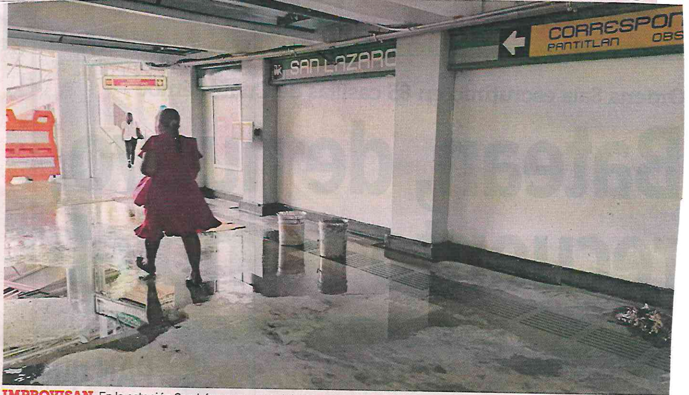
IMPROVISAN. En la estación San Lázaro, personal del Metro coloca cubetas para evitar más encharcamiento.
