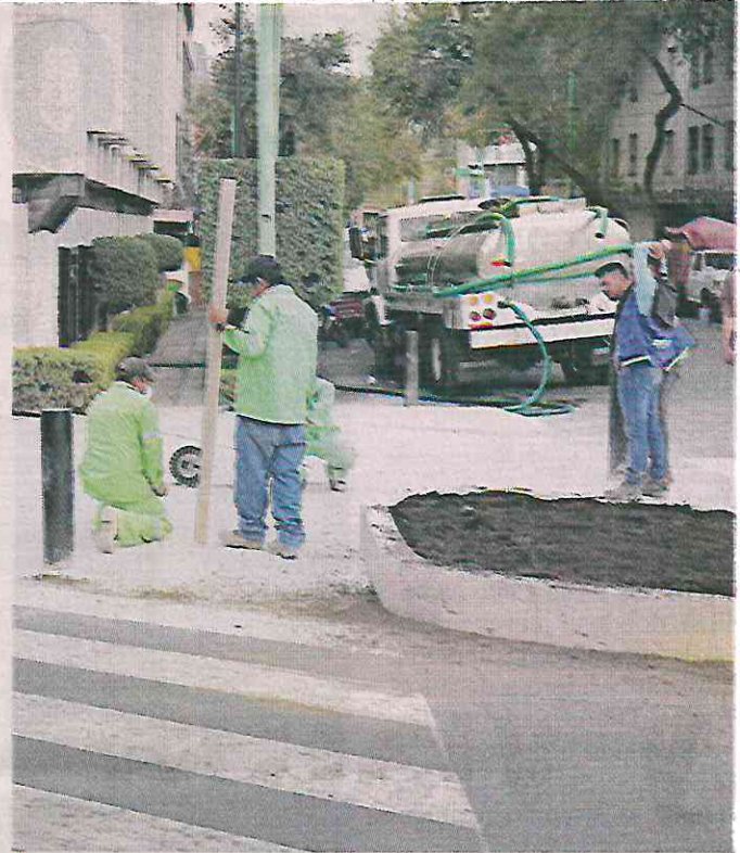
La Alcaldía Cuauhtémoc contrató a una empresa para rehabilitar banquetetas en la Colonia Doctores.
