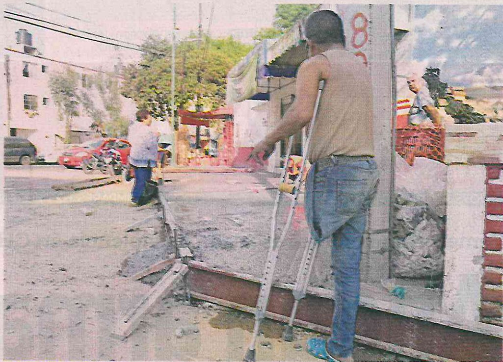
FALTA INCLUSIÓN. En la esquina de Doctor Martínez del Río y Doctor Jiménez, la banqueta fue rehabilitada, pero la rampa no fue colocada en la esquina, como establecen las normas.
