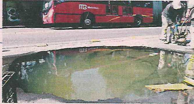
El socavón se encontraba lleno con agua potable de una fuga.
