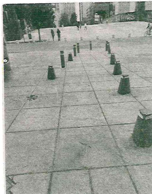
Jardineras y banquetas destruidas
