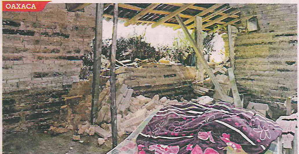
■ En las viviendas hay escombros, lodo, piedras y muebles que terminaron dañados.
