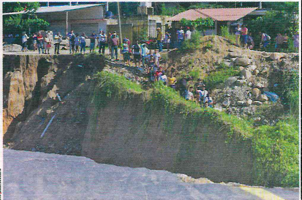
POBLADORES de la zona rural de Acapulco, quienes quedaron incomunicados al colapsar el puente de la carretera federal, en el kilómetro 21, pidieron apoyo a las autoridades, ayer.
